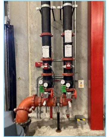
Wet-Pipe Sprinkler Risers (ESFR)
