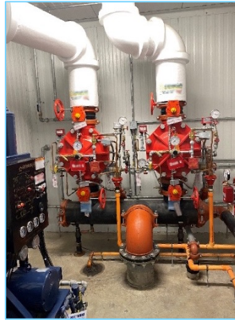
Quell System Sprinkler Risers
